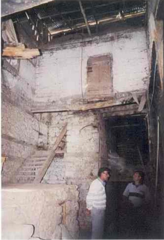
Resim 82 : Numan Ağa Konağı Üst Kata Çıkışı Sağlayan Ahşap Merdiven ve Üst Katta Yıkılmış Oda Kalıntısı
